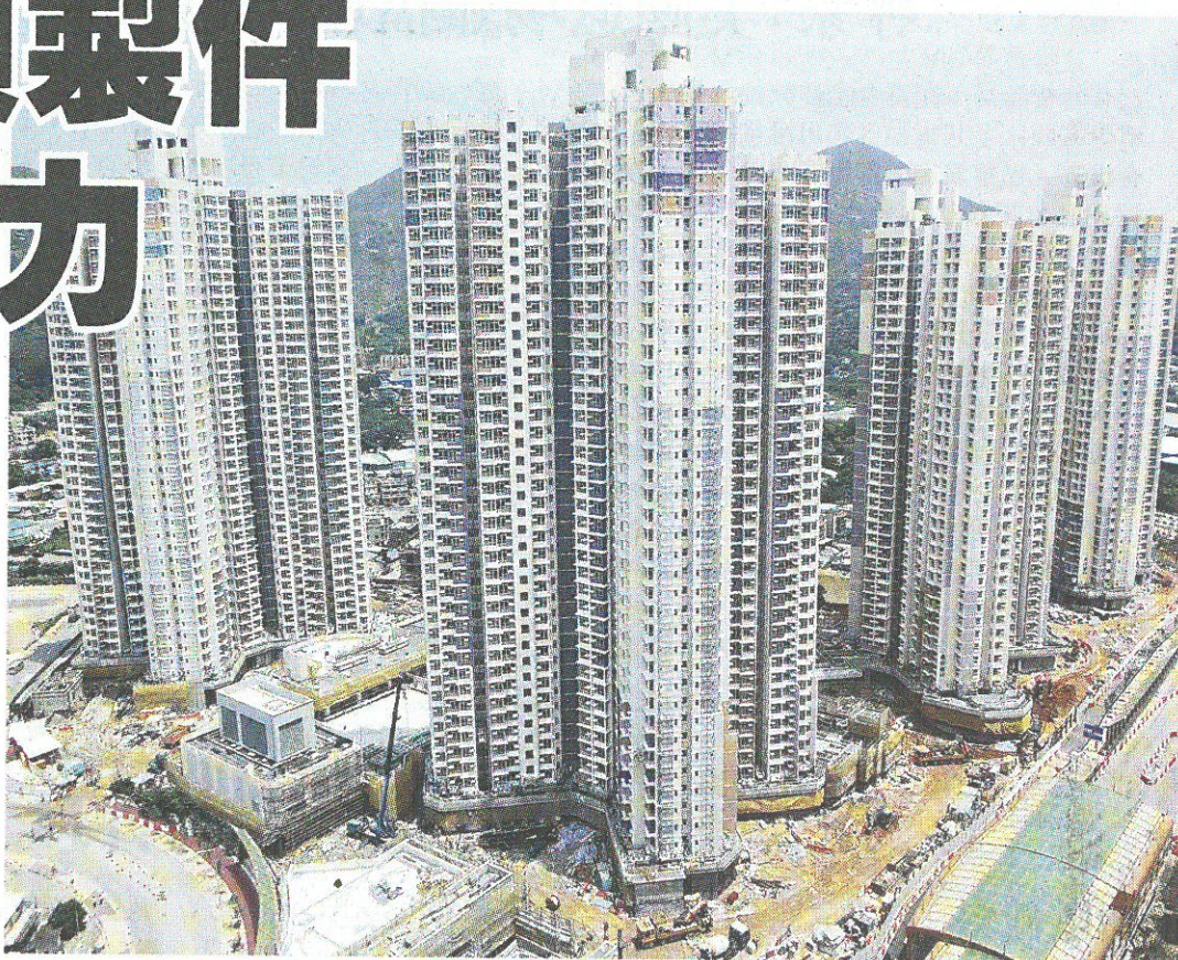
▲房屋署位於屯門第54區2號地盤採用LSCM與香港大學及香港理工大學合作，結合射頻識別（RFID）及建築信息模擬（BIM）監控預製件技術，效果理想。
